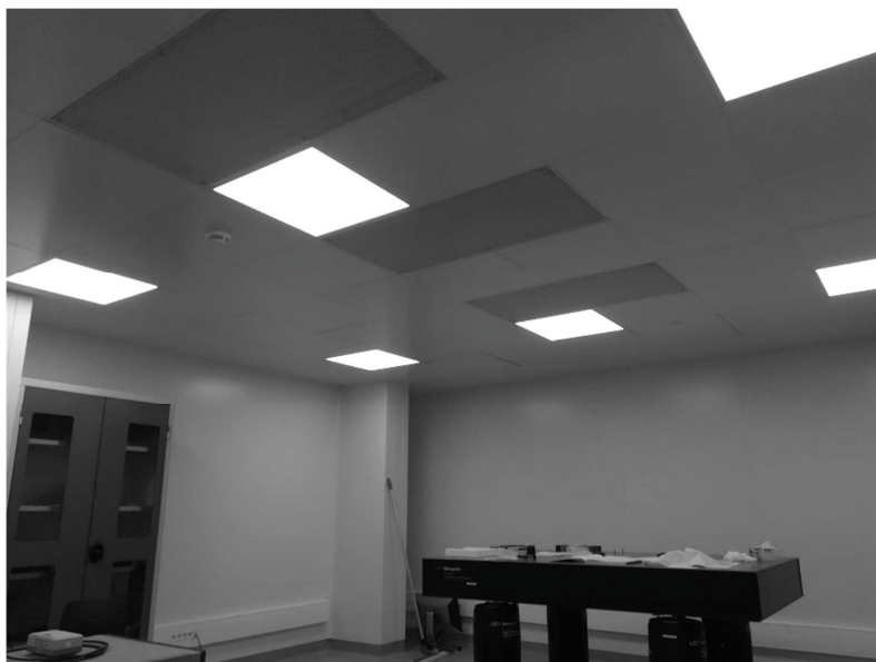
Figure A : Salle blanche du laboratoire d'optique avec les arrivées d'air débouchant du faux-plafond
