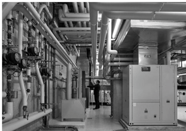
Figure E : Tuyaux d'eau chaude (à gauche) et d'eau glacée (à droite) alimentant la centrale de traitement d'air.
