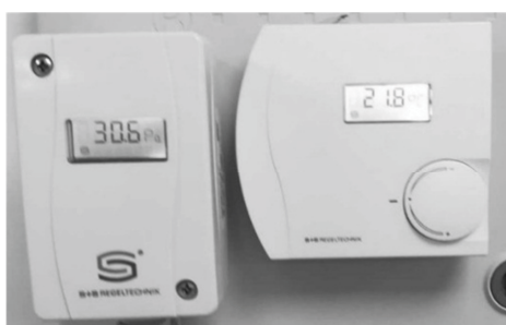
Figure B : Mesure et affichage de la température (21,8°C), de la surpression (30,6 Pa) de l'air dans la salle blanche.
